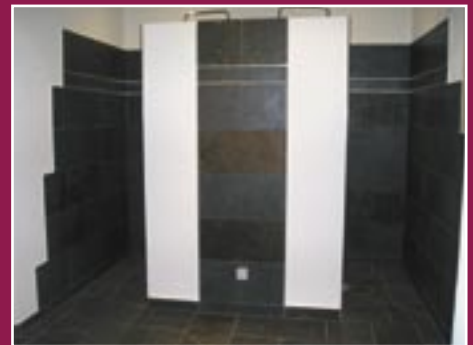
Duschanlage mit Wandfliesen Colorado
